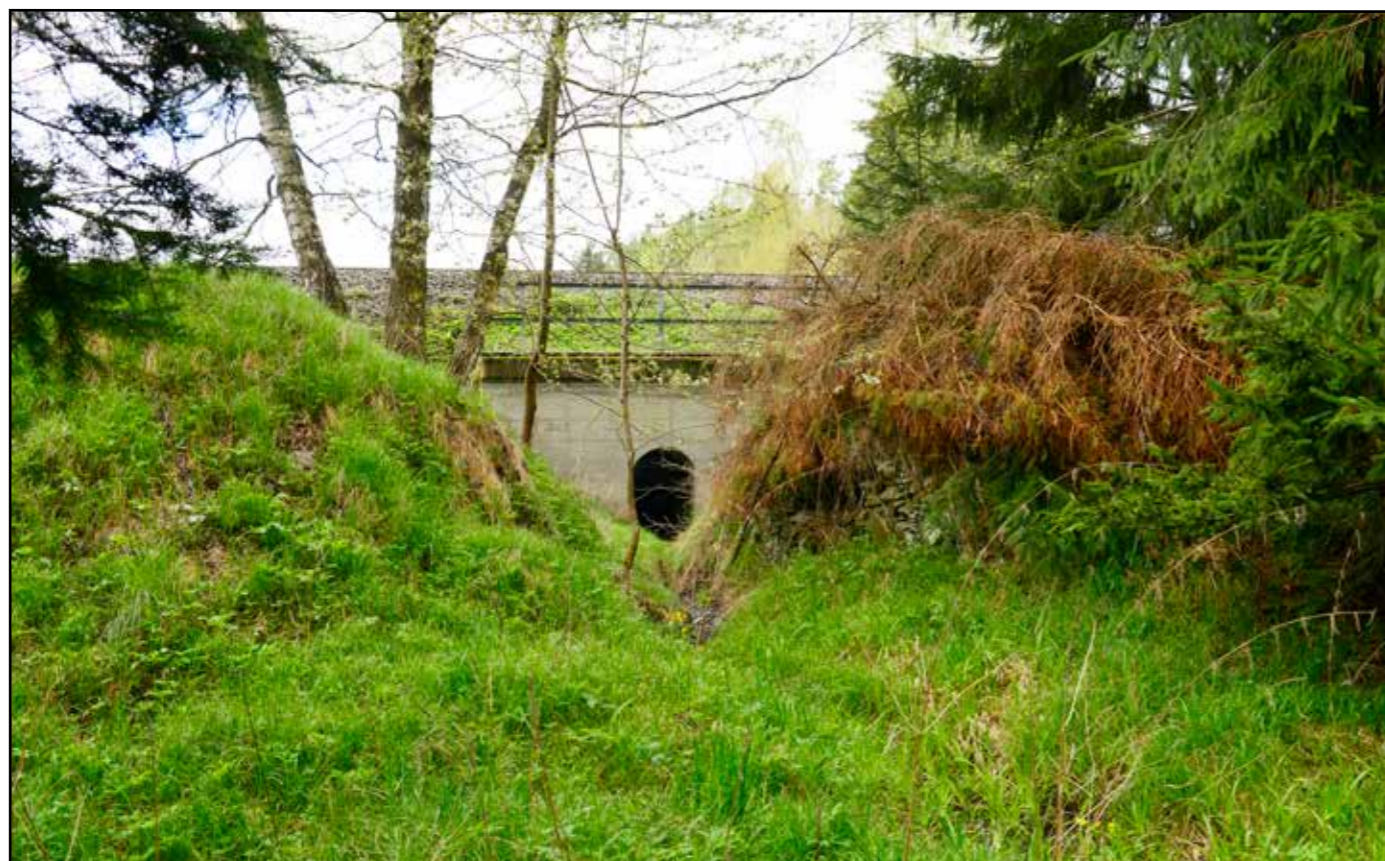
Zbytky kamenného propustku na km 71.812, 2022.
