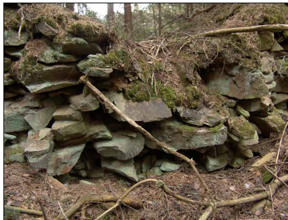
Obnažené kamenné jádro náspu před druhým mostem, 2007.
